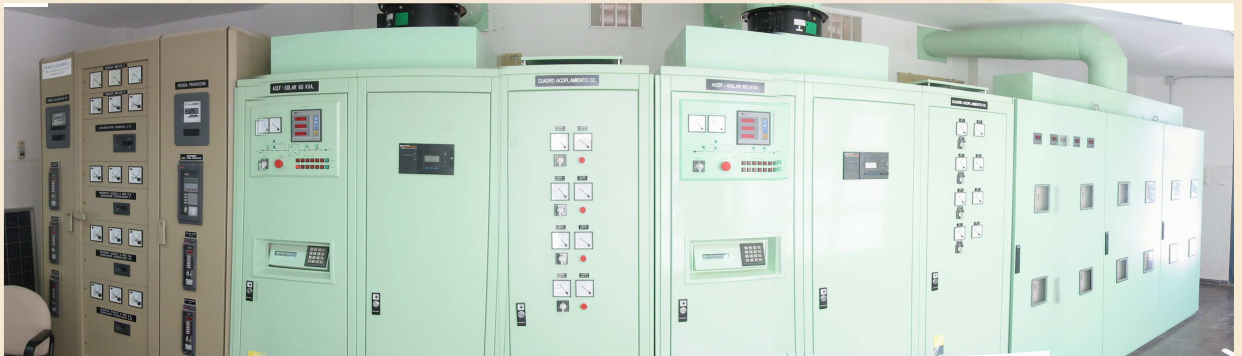
Figura 4. Sistema de acondicionamiento de potencia en el proyecto "Univer". Dos inversores centralizados de 60 kVA (en el centro de la fotografía) y veinticuatro inversores en cadena de 2 kVA (a la derecha de la fotografía)
